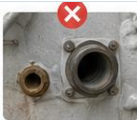
Entradas de cabos não utilizadas
