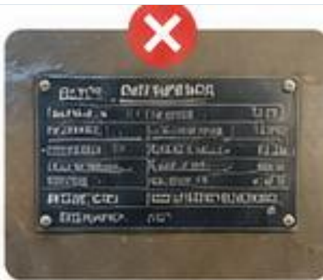
Equipamento sem marcação Ex
