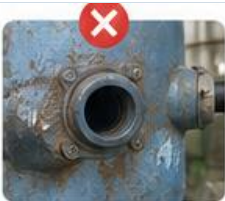
Prensa-cabo inadequado ou com
