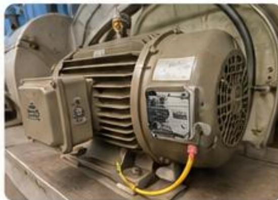
Aterramento de equipamentos Ex
