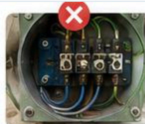
Conexões elétricas mal apertadas ou
