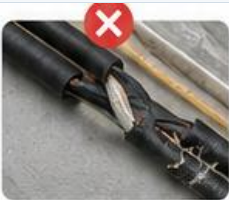
Cabos com isolação danificada
